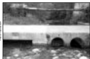
À VILLEGONDGE, SUR LE LÉZERT, LES BARRAGES QUI À TENDRE SE BORDENT, SONT RENFORCÉS PAR UNE LARGE OUVERTURE QUI FACILITE LE PASSAGE DES POISSONS
